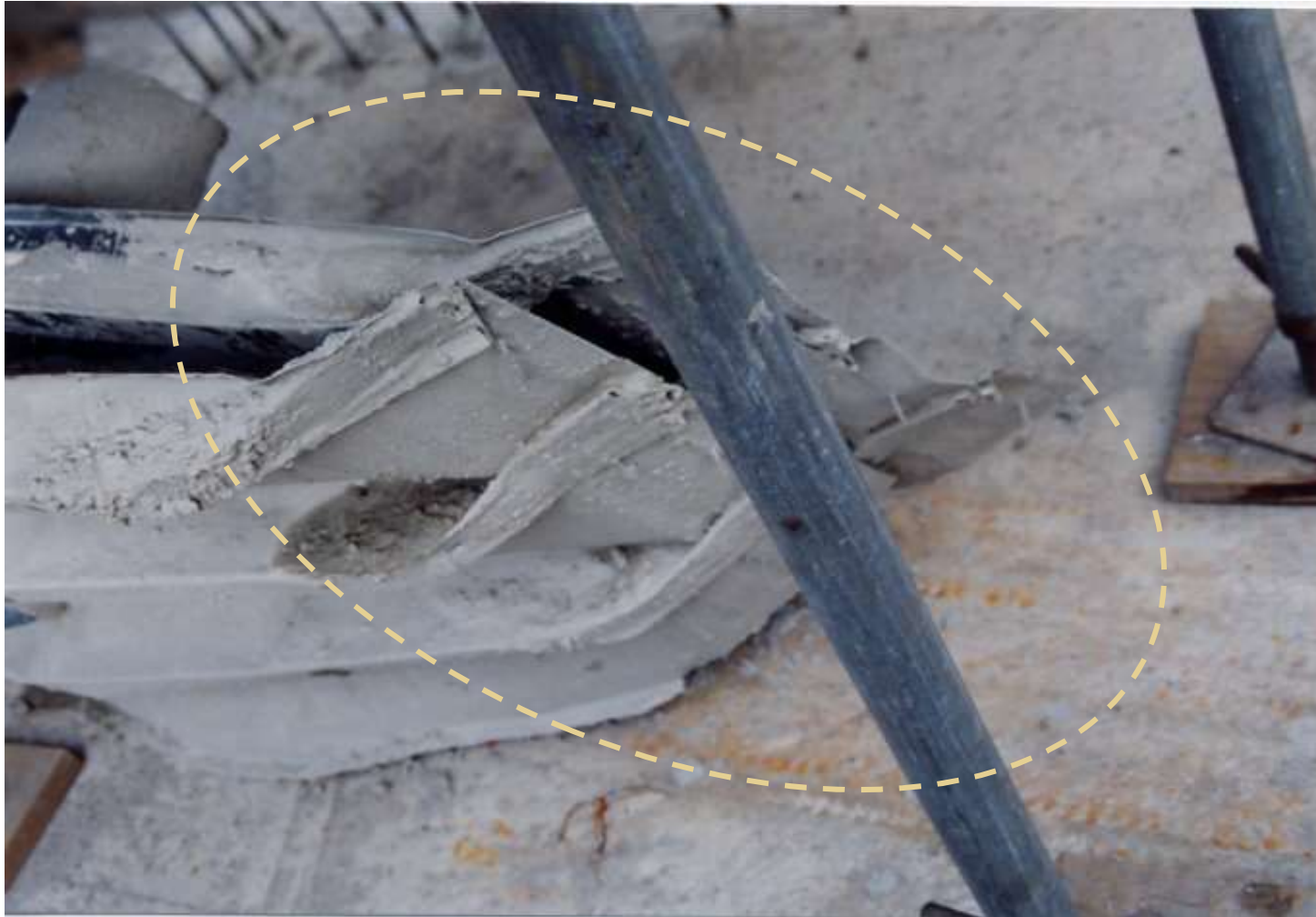
ii) 脱落デッキ(端部折曲り)状況
